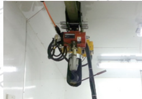
HOIST WINCH & RAIL Подъемная лебедка и рельсы
